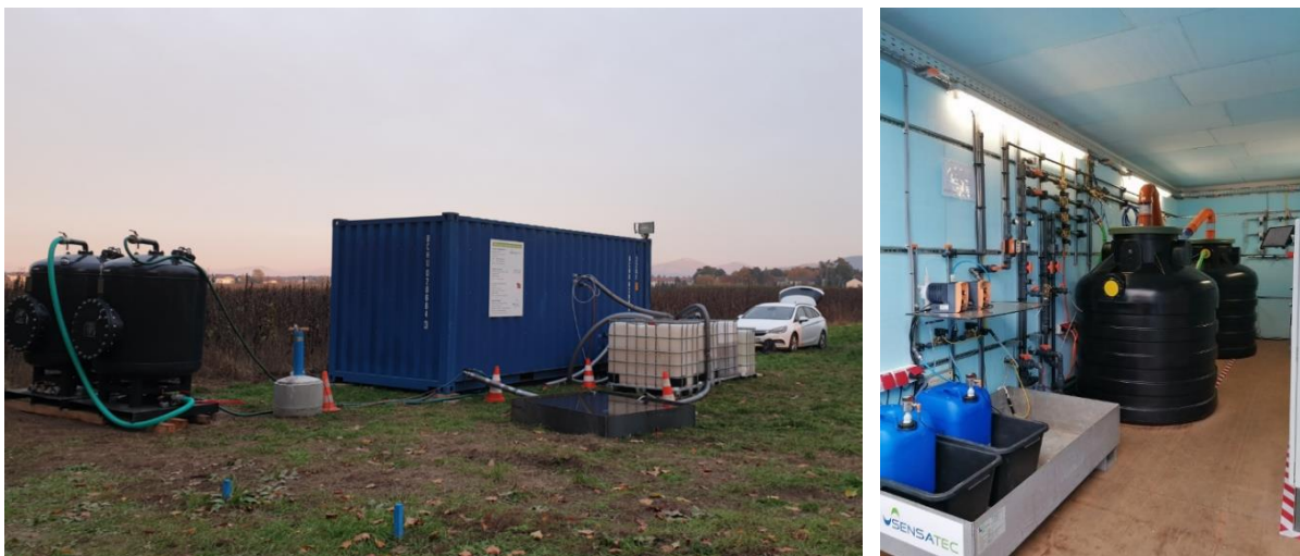
Abbildung 1: Die Sanierungsanlage auf dem Testfeld in Hügelsheim (links Außenansicht, rechts Innenansicht)
